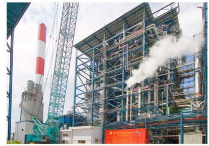
Nhà máy nhiệt điện Uông Bí (Uông Bí - Quảng Ninh)
